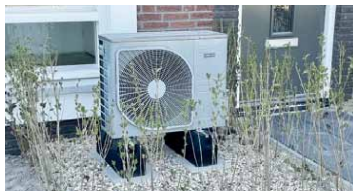
Beispiel einer Luft-Wärmepumpe. Aber in Bernau gibt es auch bereits zahlreiche Erdwärme-Sonden, die auch im Winter sehr wenig Strom brauchen.
